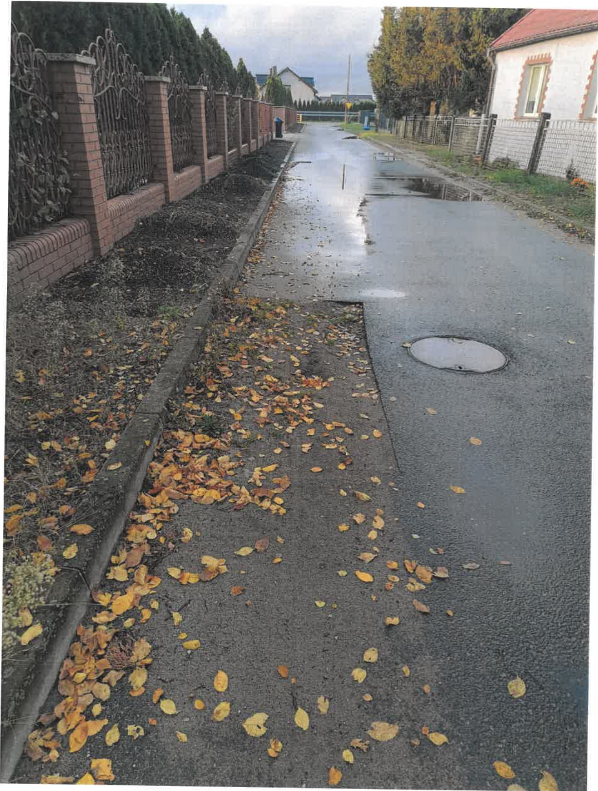
Załącznik nr 1 - Zdjęcie ubytku na ulicy Ruty
